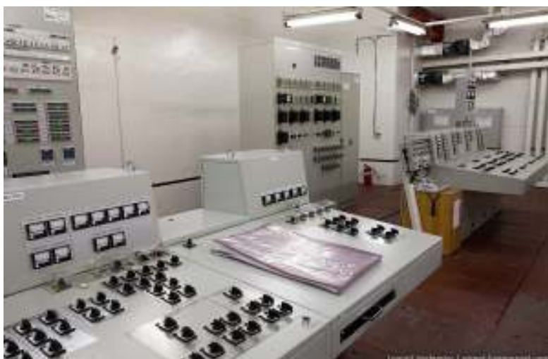
Панели резервного пункта управления
