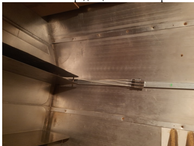
Рис. 16. Блоки детектирования и кабели систем радиационного контроля
